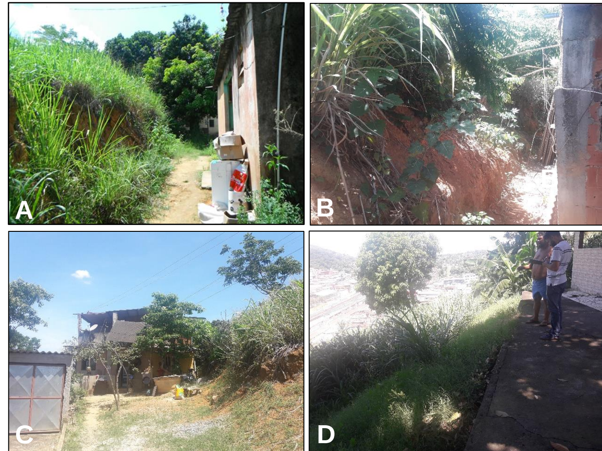
(A) Fundos de moradia a jusante da Rua Guaira. (B) Talude de corte. (C) Perfil da moradia da foto B. (D) Talude natural.
