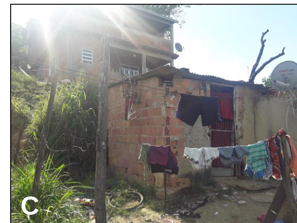
(A) e (B) Talude de corte a jusante das residências com feições erosivas e pequenas cicatrizes; (C) Residência com estrutura precária próxima ao talude de corte.
