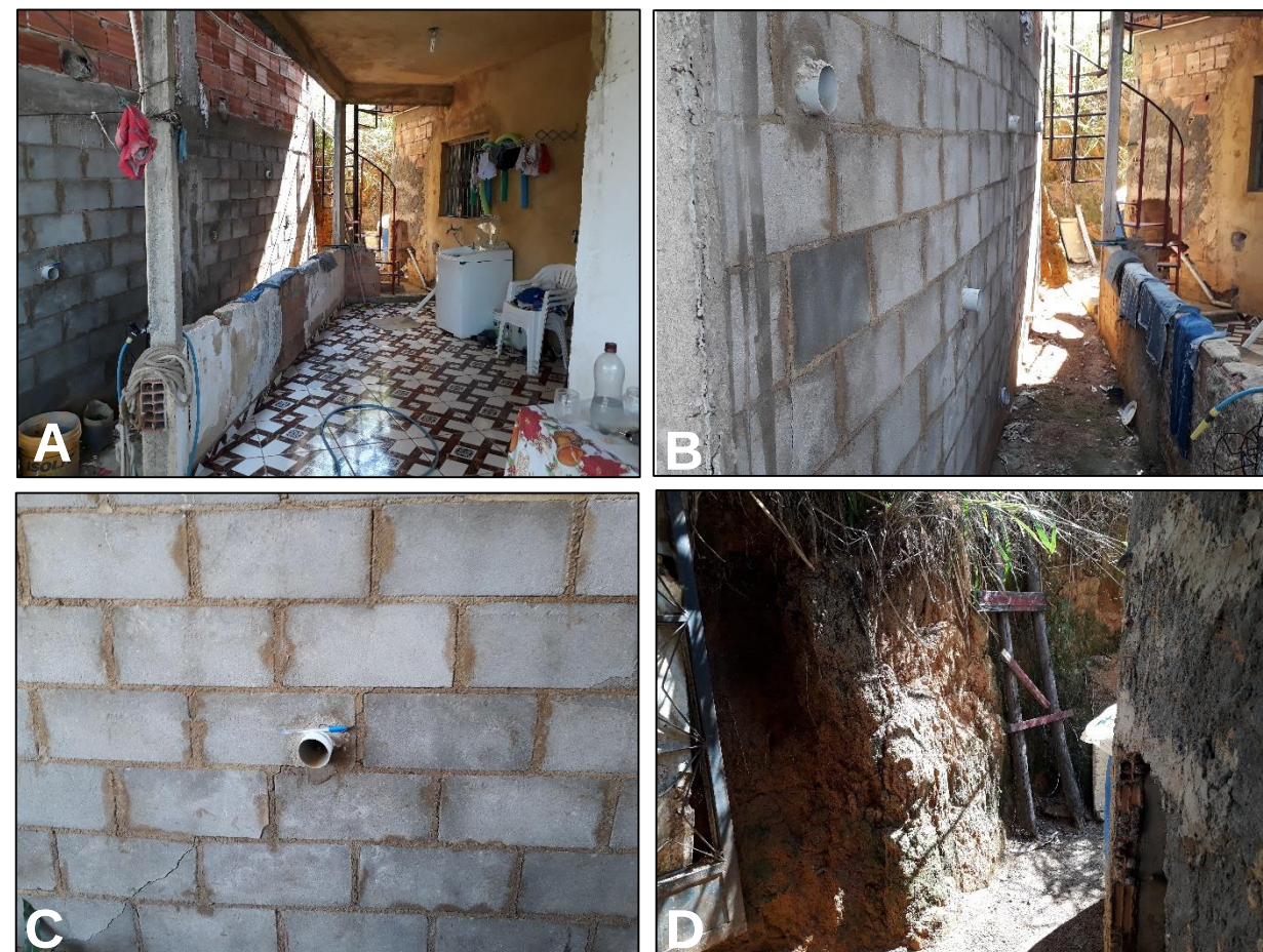
(A) Distância entre o muro e a moradia. (B) Muro embarrigado. (C) Trinca se abrindo no muro. (D) Continuação do talude sem muro, aos fundos da casa.
