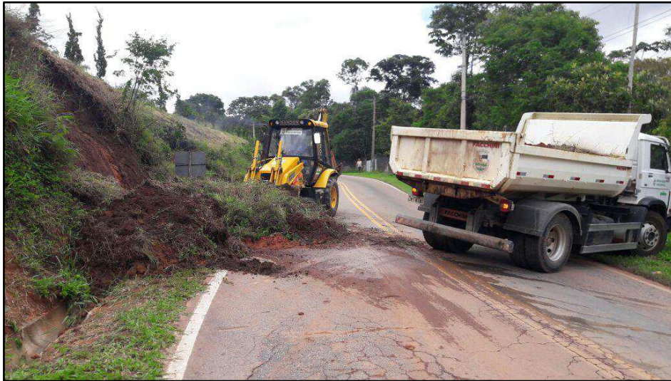
Foto 2 - Escorregamento na Estrada Amparo. Fonte: Defesa Civil de Nova Friburgo.
