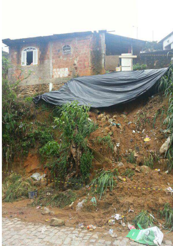
Figura 3. Escorregamento no bairro Quitandinha, Petrópolis.
