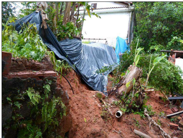
Figura 2: Imagem do talude de corte afetado na Alameda Tito Bettini em Guapimirim.
