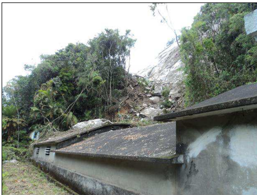
Figura 5: Estação de abastecimento de água com destaque para o material deslizado no dia 14/11.
