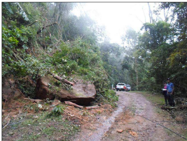
Figura 3: Bloco rochoso mobilizado pelo escorregamento na Estrada do Garrafão em Guapimirim
