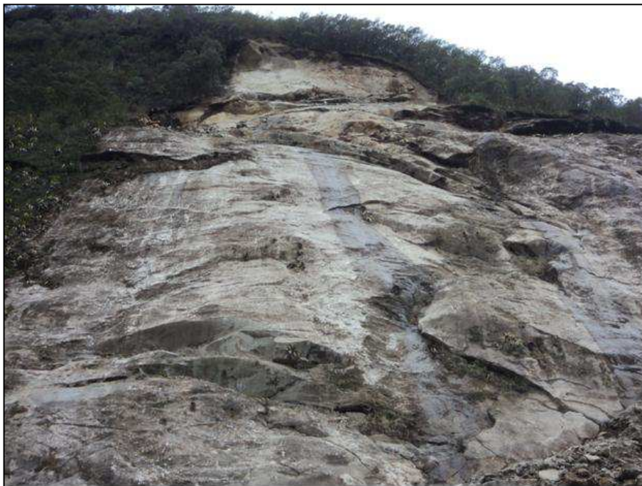
Figura 2: Fraturas tectônicas e de alívio observadas na encosta rochosa. Destaque para a percolação de água entre as fraturas.
