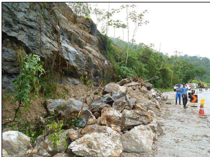
Figura 2 – Queda de blocos, na BR-116, Rio-Teresópolis, km 106, Guapimirim, RJ.
