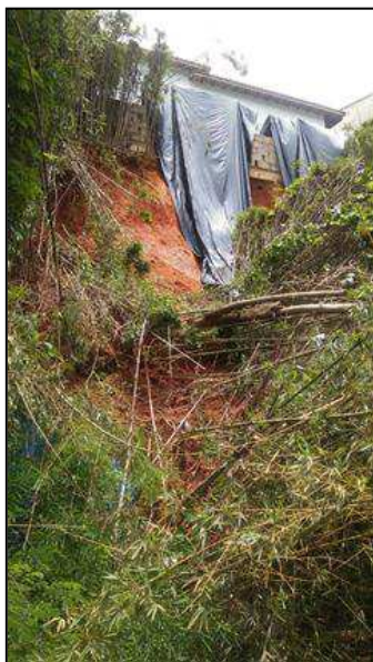
Figura 6: Escorregamento planar que destruiu um quarto aos fundos da casa nº 617 na Rua Cel. Rocha Santos no município de Resende.
