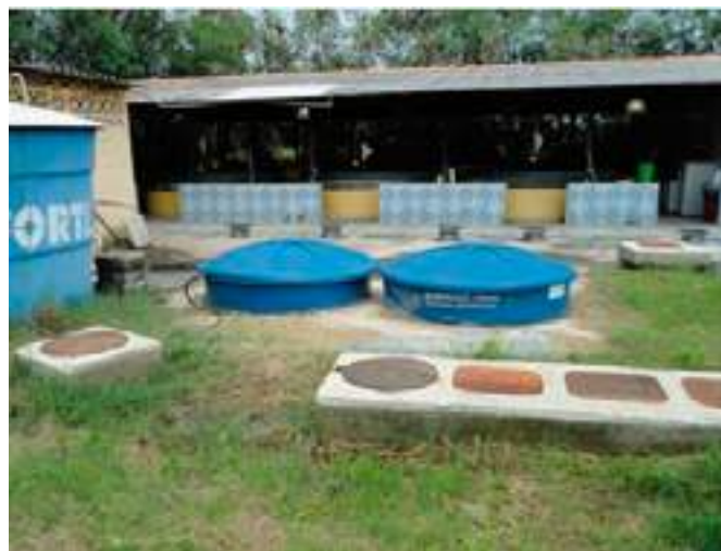
Figura 39. Sistema de reúso de água com filtros biológicos (aeróbio e anaeróbio) no setor de crescimento e terminação de rãs da EEAAPM
