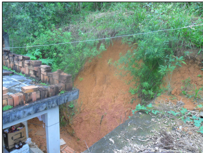
FOTO 2 – Foto que representa o setor CMB-FM-28. A casa localizada no sopé do talude possui depósito de escorregamento oriundo de talude em solo residual jovem/maduro.
