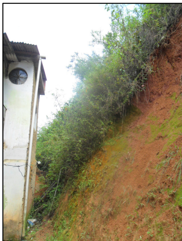
FOTO 1 - Foto representativa do setor CMB-FM-30. Destaque para a pequena distância entre talude de solo residual e a moradia em risco.
