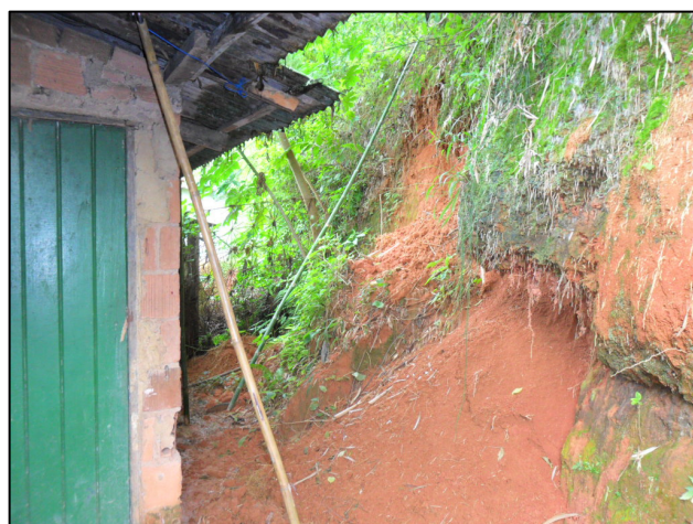
FOTO 4 – Foto representativa da região em risco iminente do setor CMB-FM-19. Apresenta depósito de escorregamento em fundos de moradia próximo ao talude em solo residual maduro.
